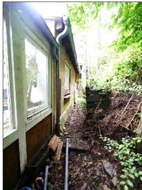
Bild 30: nicht genehmigte Anbauten an der Gebäuderückseite
