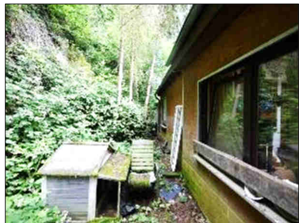
Bild 32: nicht genehmigte Anbauten an der Gebäuderückseite
