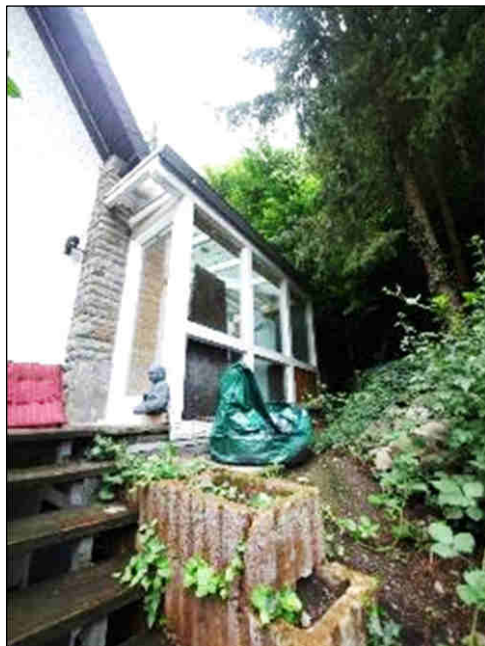
Bild 29: nicht genehmigte Anbauten an der Gebäuderückseite
