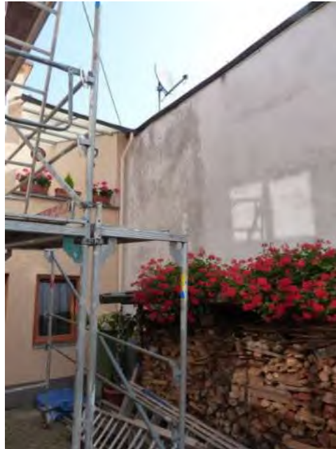
Defekte Dachentwässerung zum Nachbargrundstück
