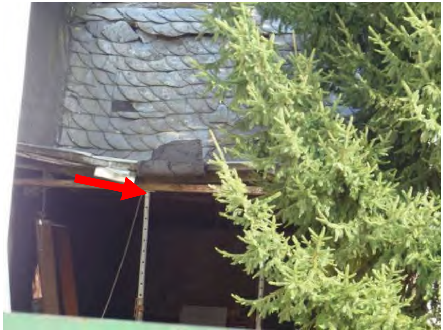
Ehemalige Scheune (einsturzgefährdet)
