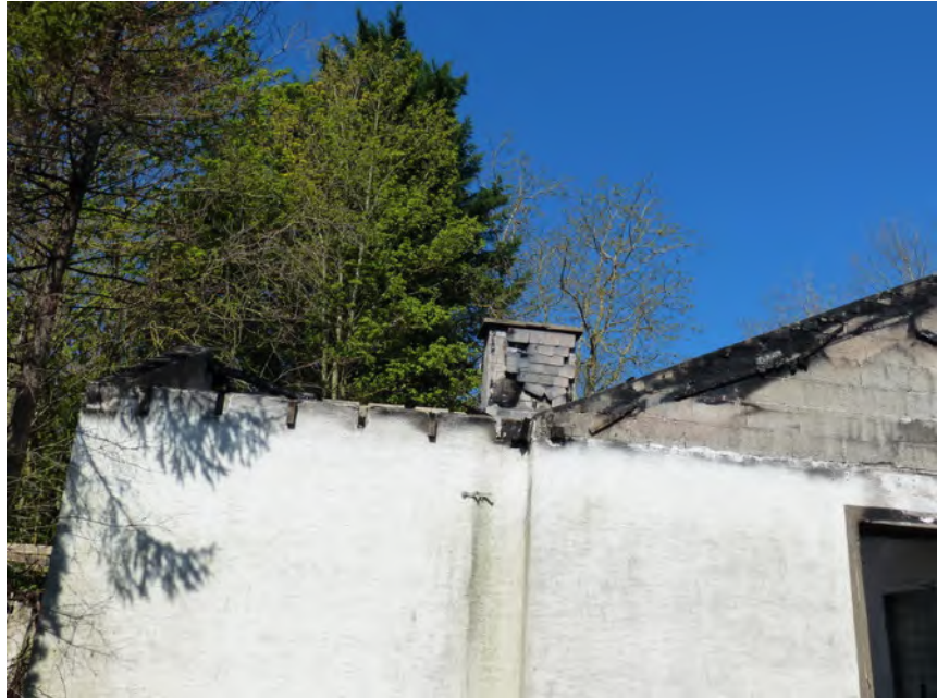
Dachstuhl wurde vollständig zerstört
