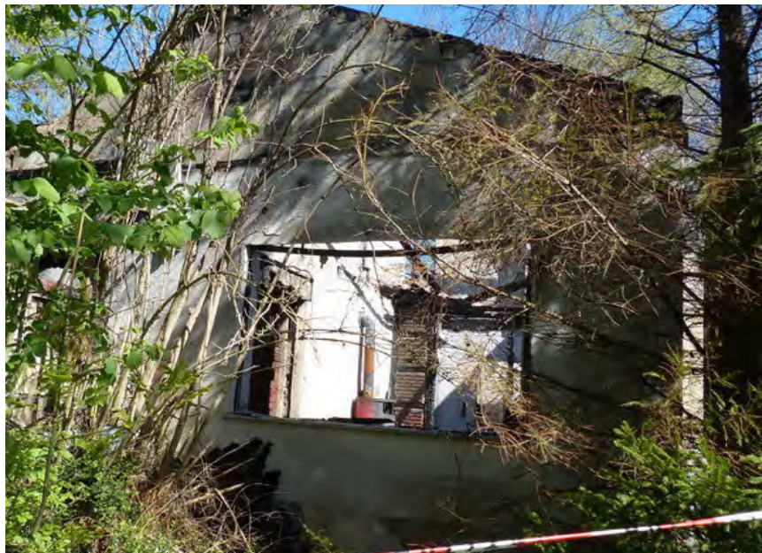
Blick vom Gelände in das Brandschadenobjekt
