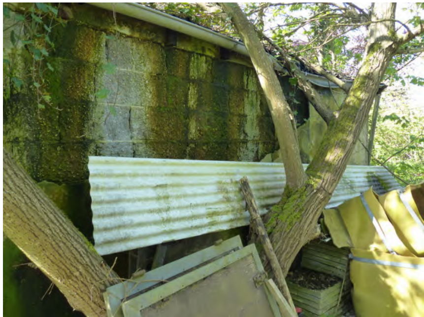
Grundstück mit Unrat vermüllt/Zustand der Garage
