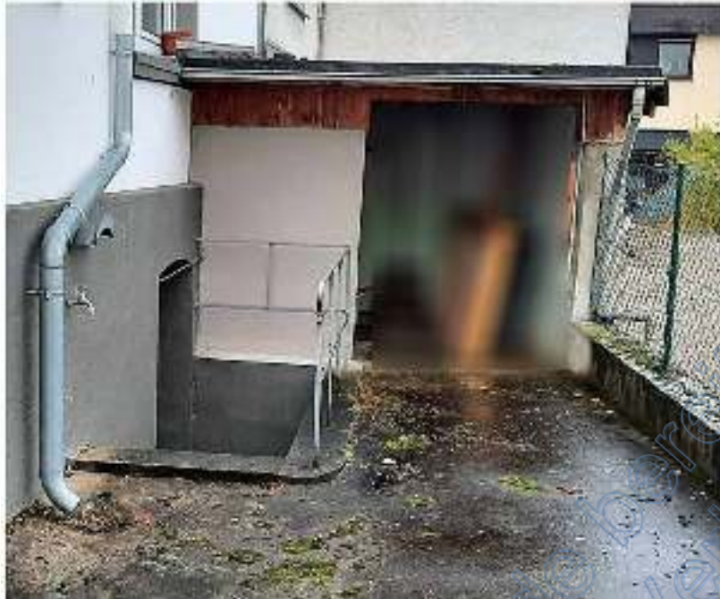
Foto 09 – Schuppen im Hof mit undichtigem Dach
