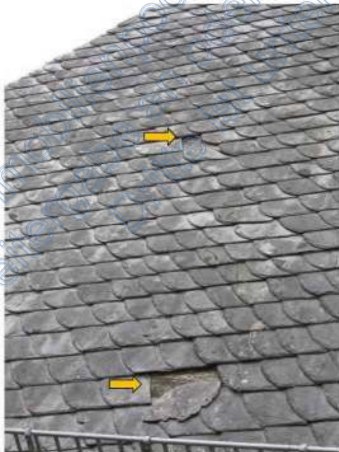
Foto 8: Stall-/Scheunengebäude, beschädigte Dacheindeckung
