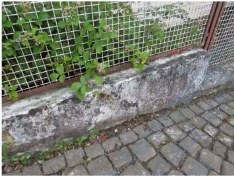
Foto 9: Beschädigungen an der Sockelmauer, korrodierter Metallzaun
