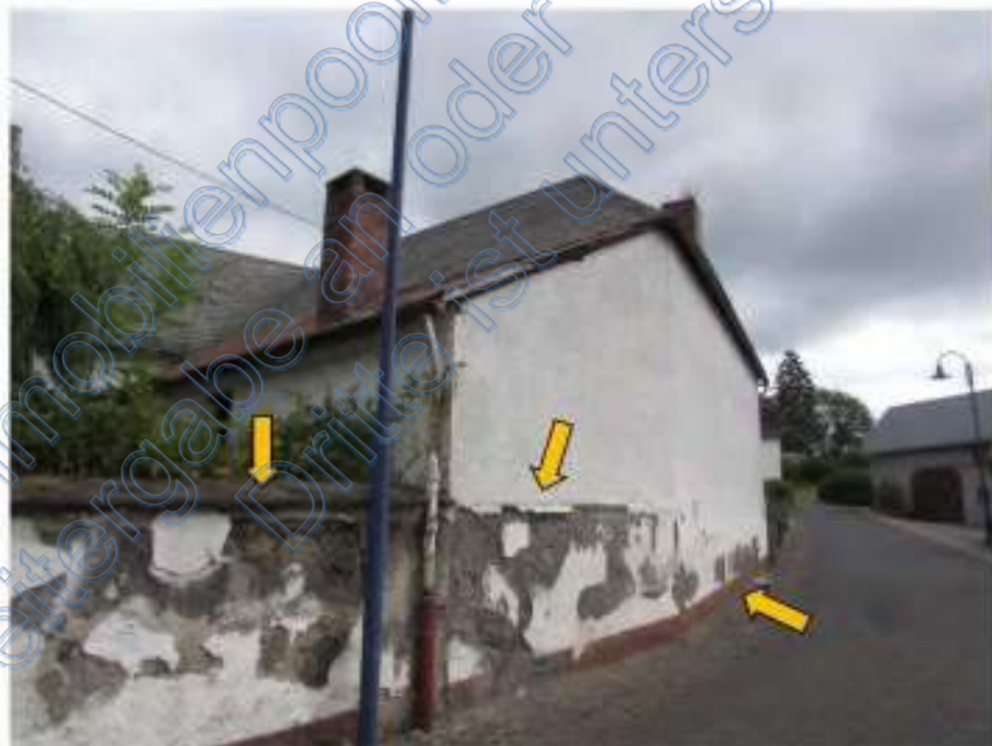
Foto 6: Stall-/Scheunengebäude, Straßenansicht, Beschädigungen an der Fassade und der Begrenzungsmauer
