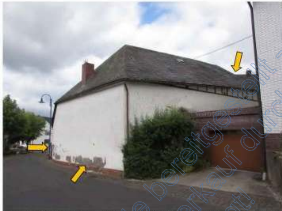
Foto 7: Stall-/Scheunengebäude, Straßen-/Seitenansicht, Schäden an der Fassade
