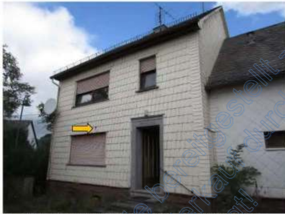
Foto 3: Wohnhaus, Hofansicht, beschädigte Fassadenverkleidung
