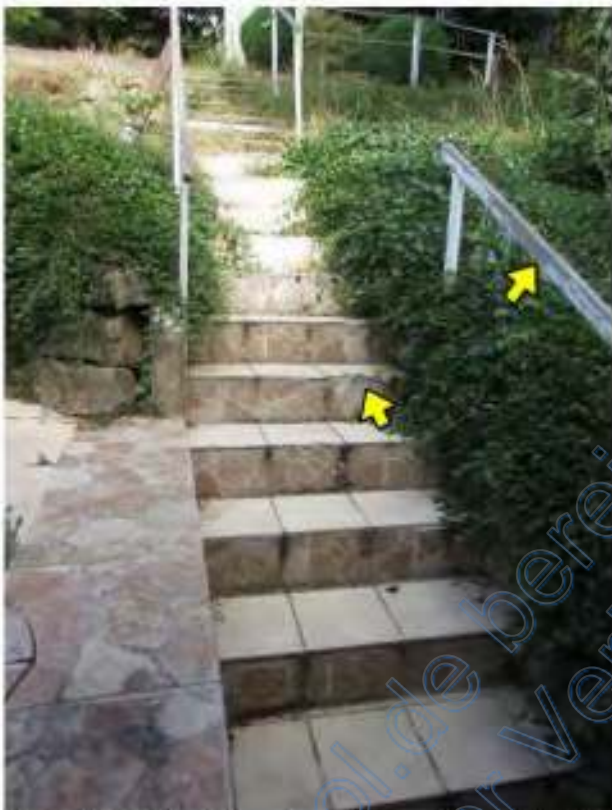
Foto 27: rückwärtiger/westlicher Grundstücksbereich, Außentreppe: beschädigter Fliesenbelag, verwittertes Holzgeländer
