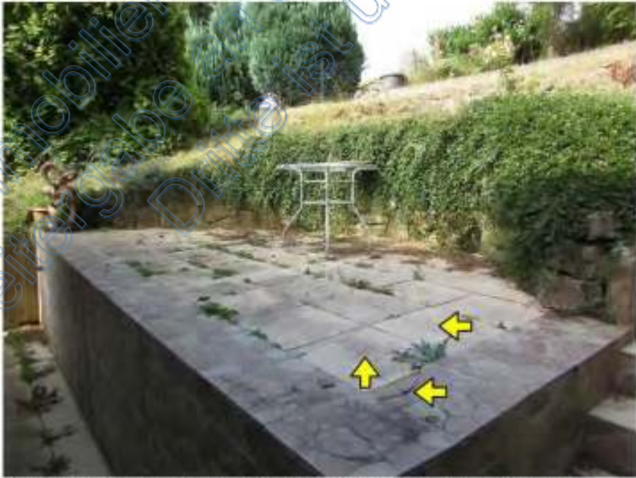
Foto 28: rückwärtiger/westlicher Grundstücksbereich, Terrasse: gerissener Bodenbelag
