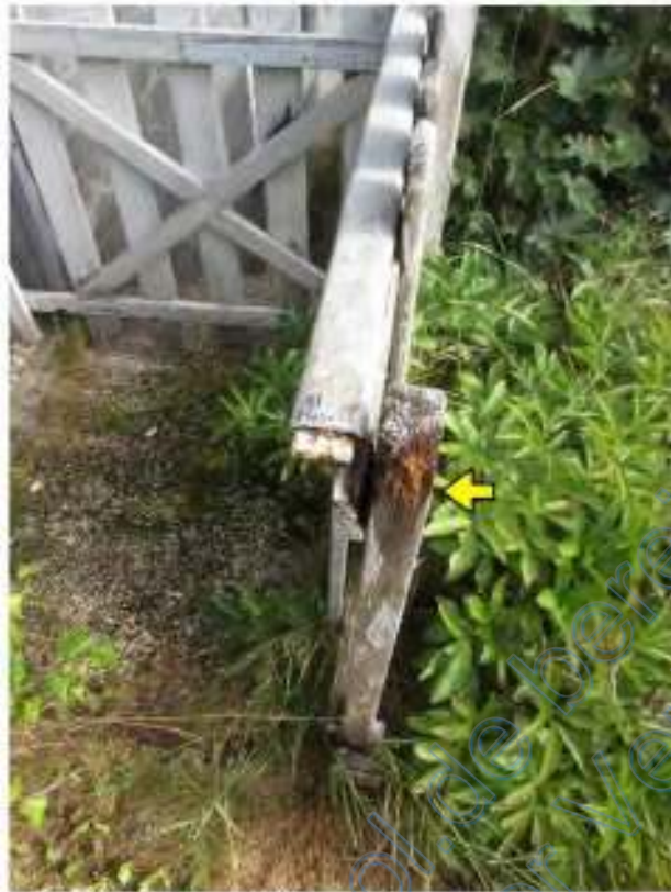
Foto 25: südlicher Grundstücksbereich, Umgang: tlw. morsches Holzgeländer
