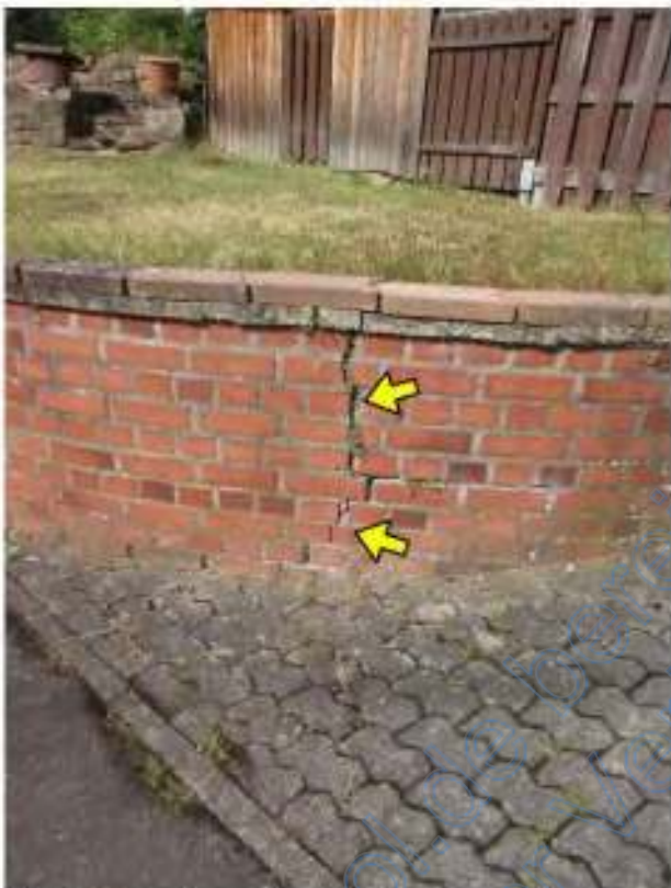
Foto 23: straßenseitige Stützmauer, Risse
