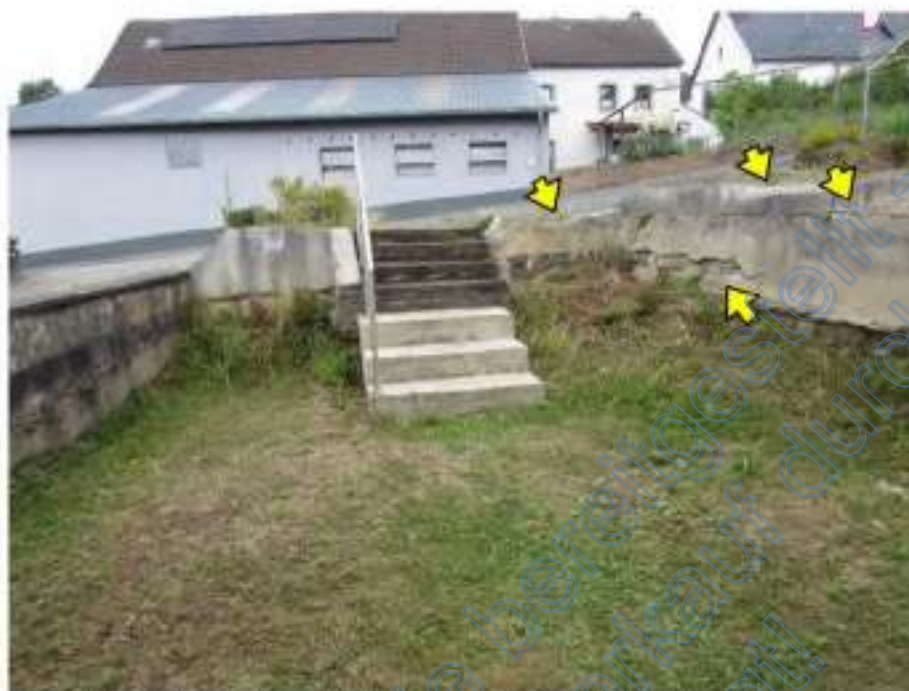
Foto 33: vorderer Grundstücksbereich: beschädigte Soekel
