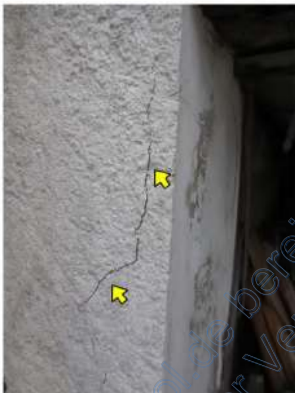
Foto 29: Nebengebäude, Risse in der Fassade
