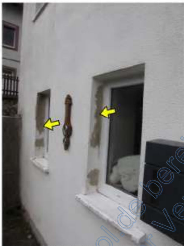
Foto 5: Wohnhaus: nicht abschließend beigearbeitete Fenster
