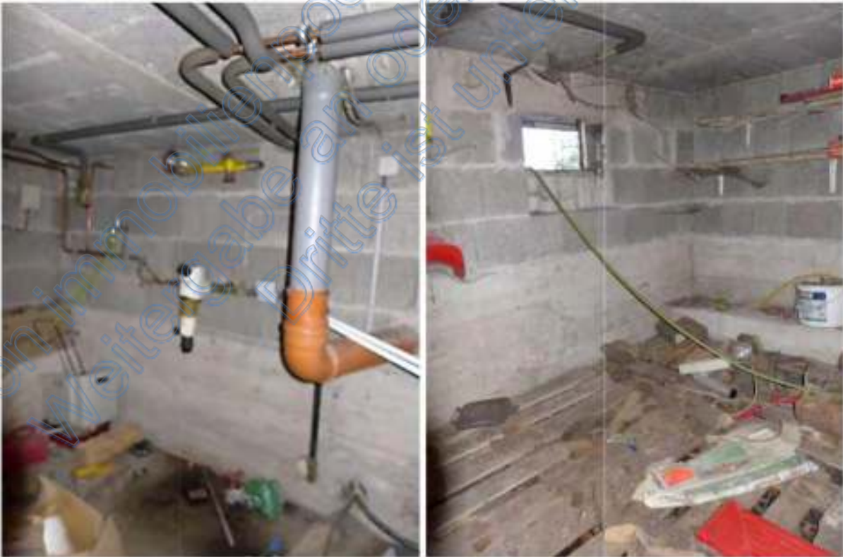
16 a Leitungen im Keller
