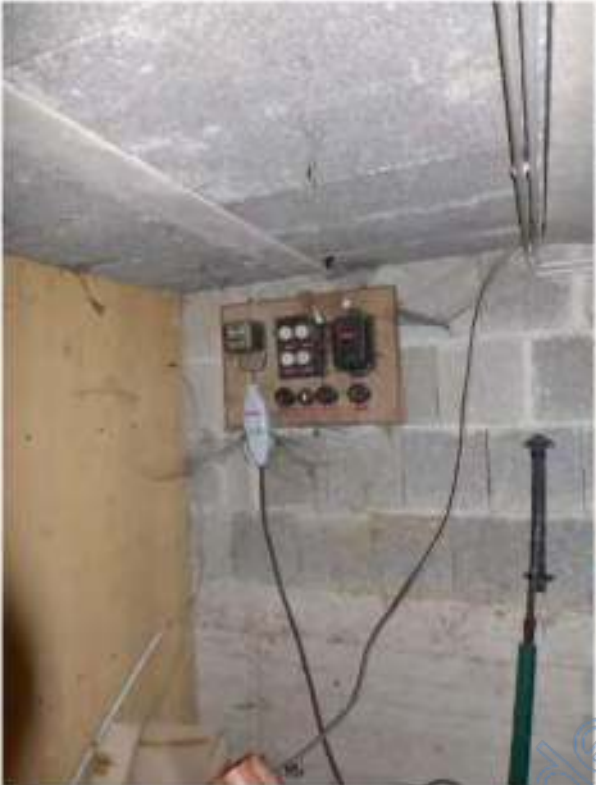
17 a Installationen im Keller
