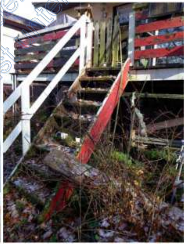
24 b Zustand Terrassentreppe
