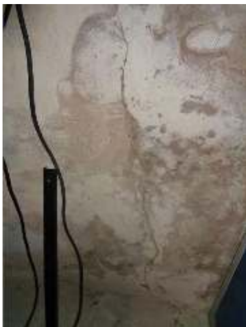
Bild 49: Kellergeschoss, Kellerraum 2, Verfärbungen
