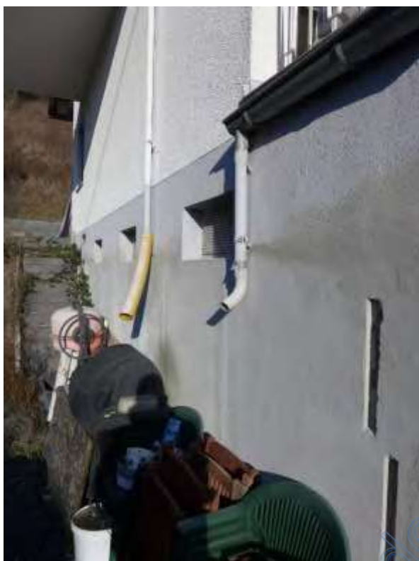
25 a fehlender Entwässerungsanschluss
