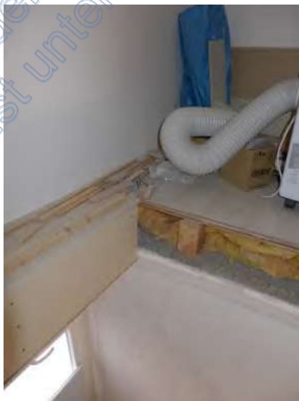
24 b fehlender Deckenabschluss Spitzboden
