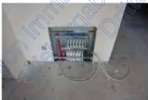
Heizkreisverteilung der Fußbodenheizung im Erdgeschoss (Wohnung Nr. 1)
