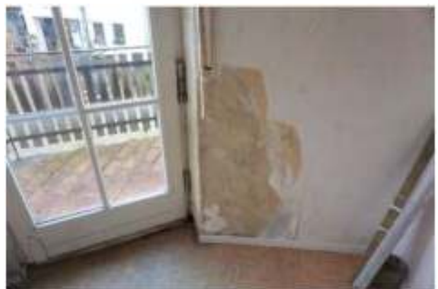
Feuchtigkeitsschäden im Bereich der Balkontür
