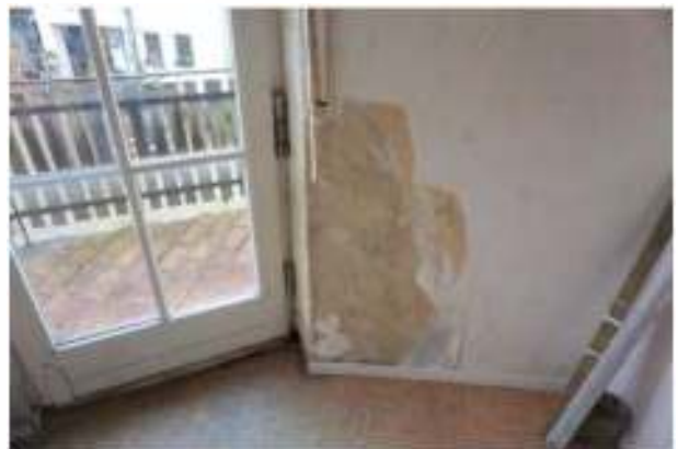
Feuchtigkeitsschäden im Bereich der Balkontür
