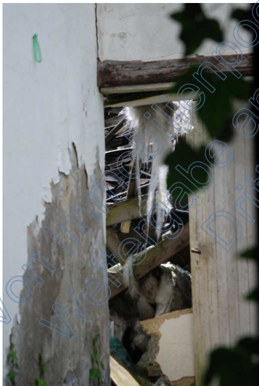
Innenansicht Packhalle, Außenwand teilweise eingestürzt Dach komplett eingestürzt
