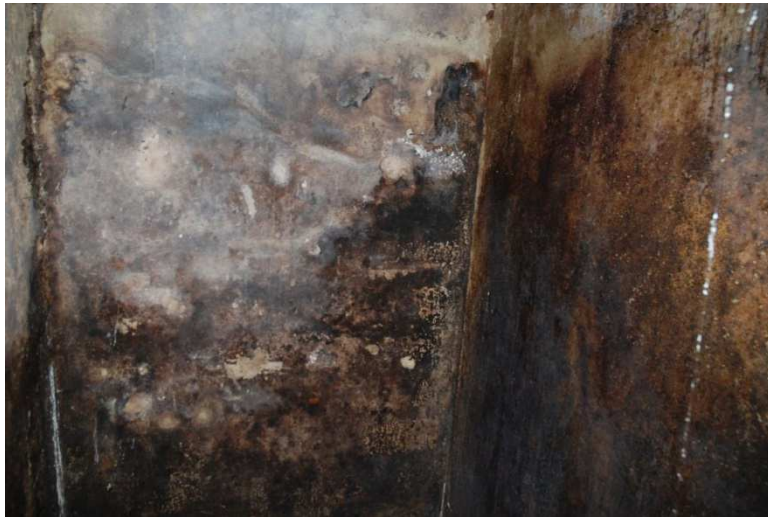
Innenansicht Keller, Feuchtigkeitsschäden
