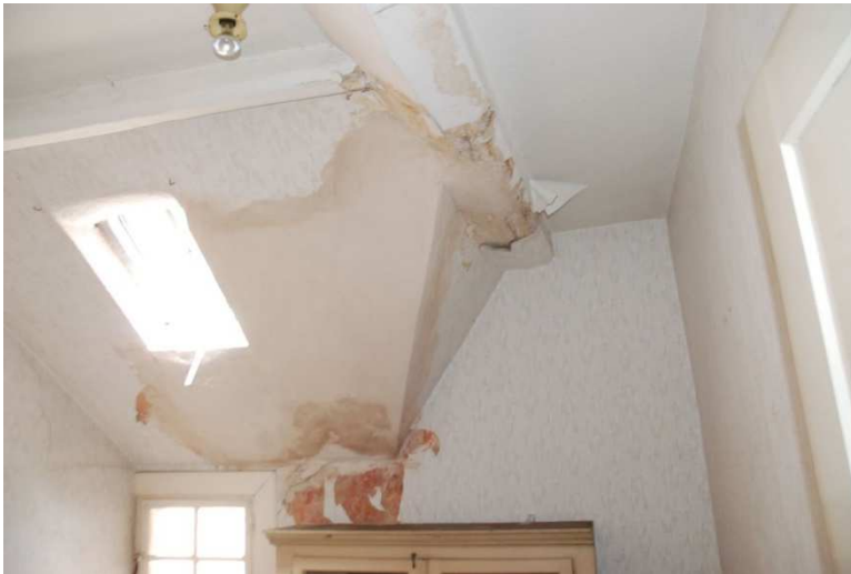
Detail Wasserschaden, Dach undicht
