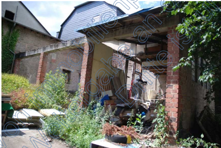
Vorderansicht Garagen/Gerätelager, Dach teilweise eingestürzt
