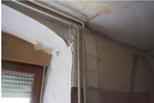
Schäden im Bereich des Fensters
