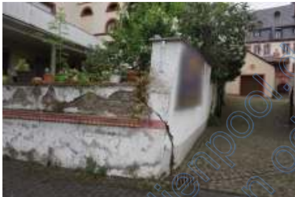
schadhafte Mauer entlang der Straße
