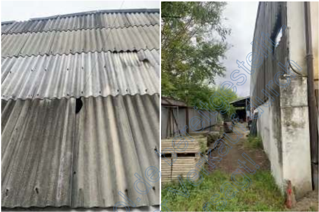
Schäden an der Außenhülle
