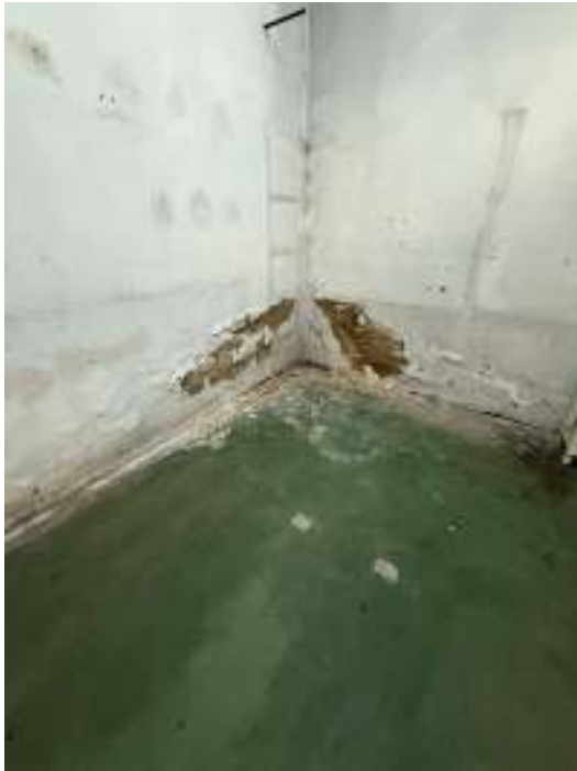
Abplatzungen / Feuchtigkeit Außenwand Werkstatt
