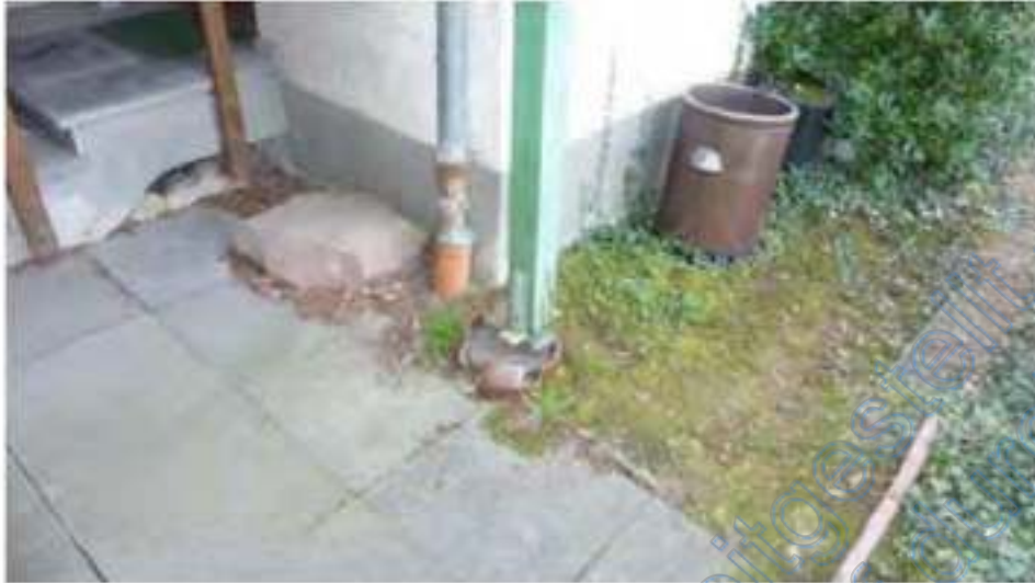
Schadstellen (Hausecke – Dachabflussrohr – und provisor. Abstützung Holzeingangsvordach
