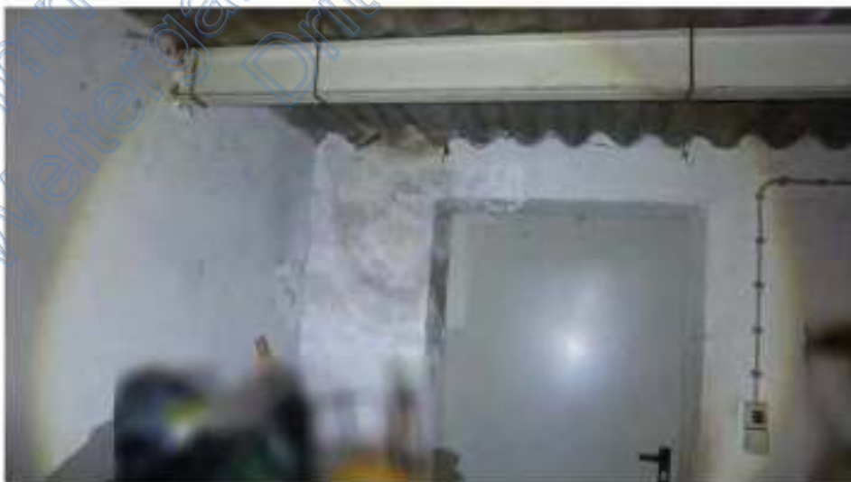
Feuchteschäden Decke-/Wandbereich Garage
