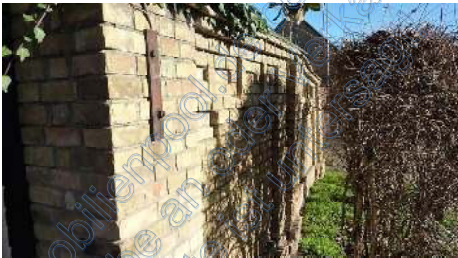
Einfriedungsmauer Teilbereich Schadstelle rel. instabil nach außen gedrückt
