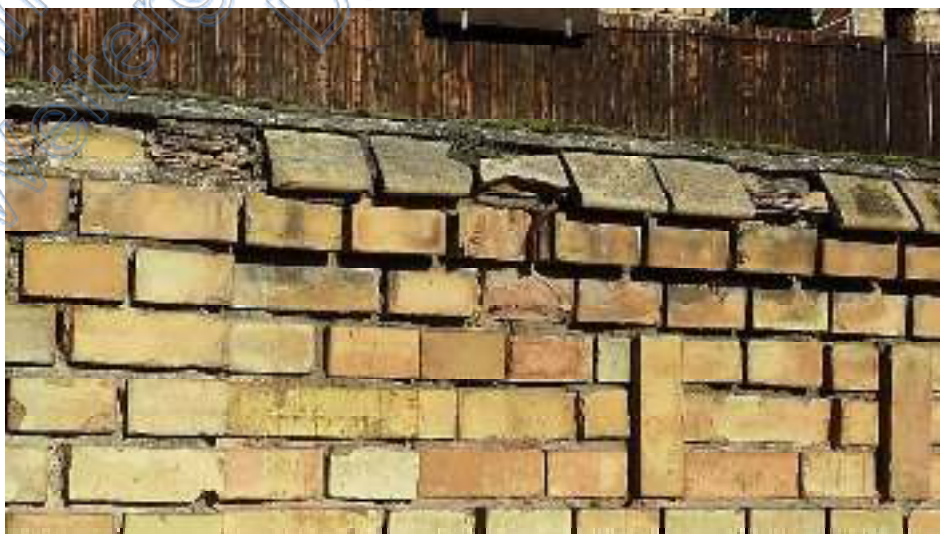
Einfriedungsmauer Teilbereiche mit Schadstellen
