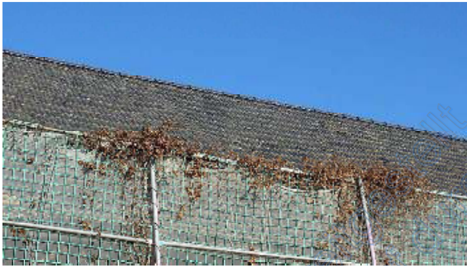
leichte Dachwellen in Dachfläche Weinlagergebäude
