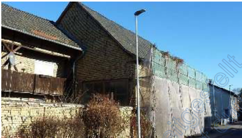
Weinlagergebäude mit Gerüst wegen Schadstellen im Dach- und Traufbereich, soweit erkennbar
