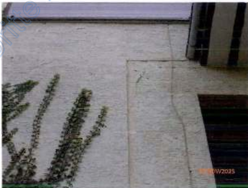
Ansicht von Norden, schadhafte Fassade
