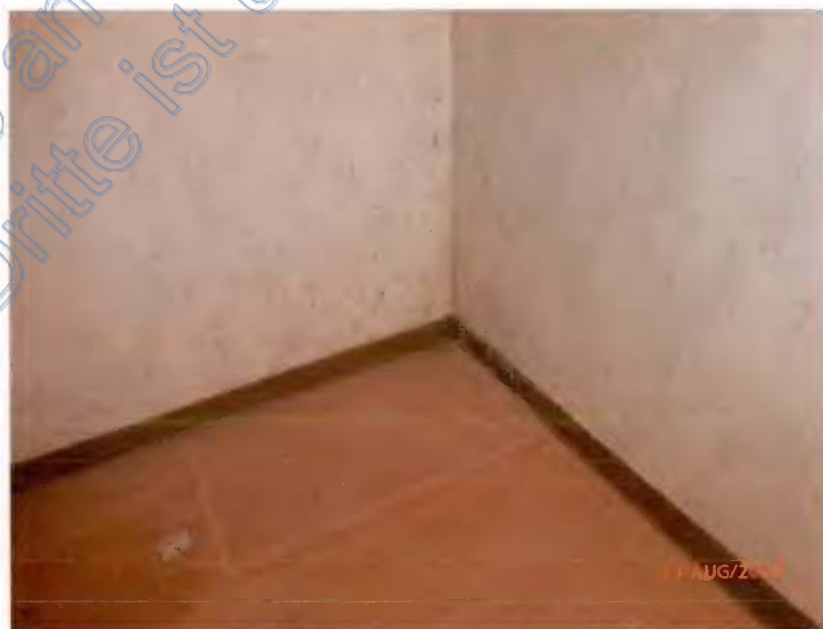
Innenansicht Erdgeschoss, Schimmel
