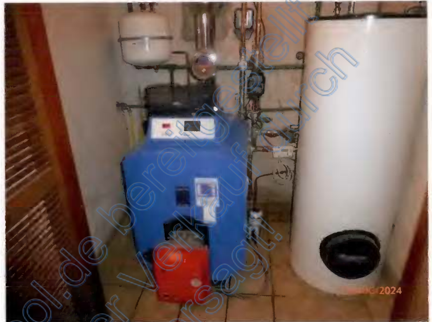
Innenansicht Kellergeschoss, Zentralheizung
