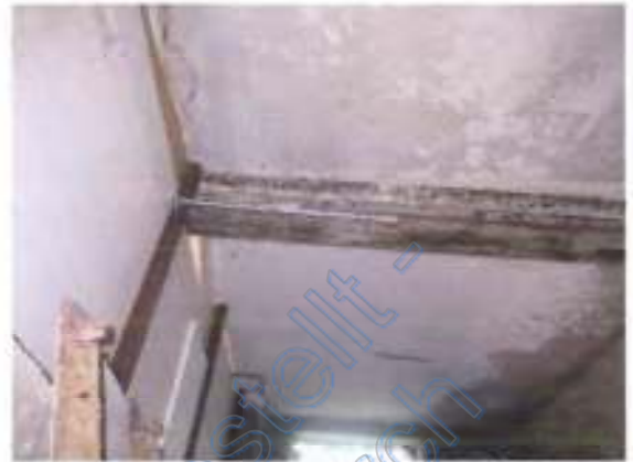
Korrodiertes Trage- und eckenschäden Scheune
