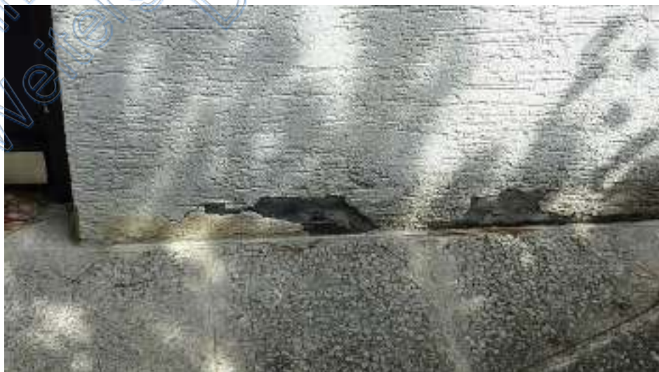
Putzschäden Haussockel Bereich Einliegerwohnung
