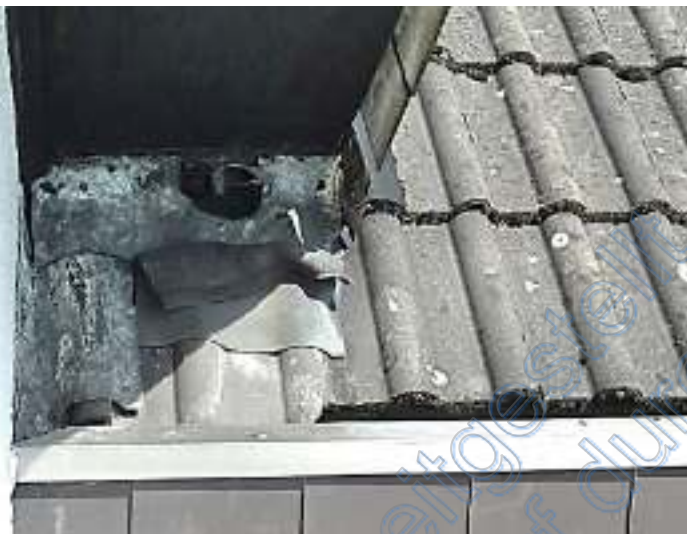
Schadstellen in der Blechverwahrung an der Überschneidung Dach Bewertungsobjekt zu Dach Nachbargebäude
