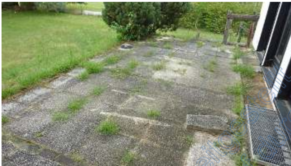
Terrasse mit Abnutz.ersch. und Schadstellen
