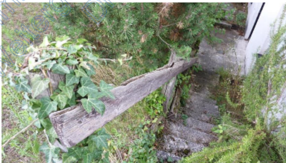
Außentreppe und Geländer zur KG-Einliegerwhg. mit erheb. Abnutz.ersch. und Schadstellen
