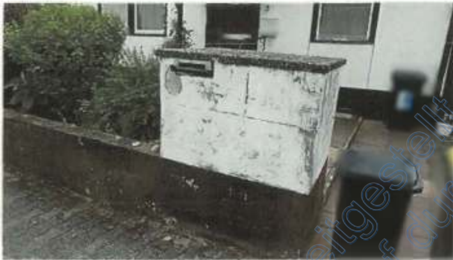
Beton- / Mauerpfeiler mit Abnutz.ersch. / Schadst.
