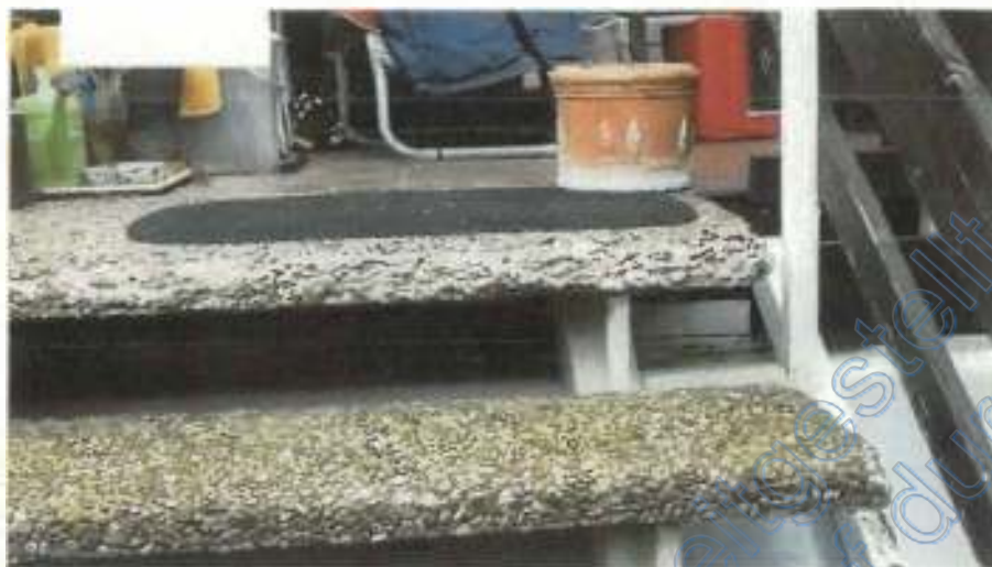
Außentreppe zum Balkon rückseits mit Schadstellen
