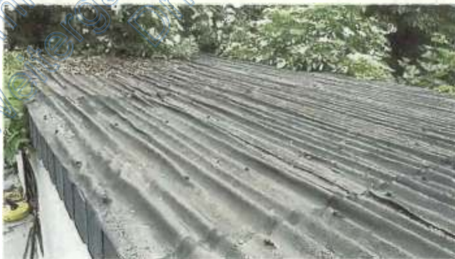
unzeitgemäße Ondulinewellpappen-Deckung o.ä. mit erheb. Schädstellen / Feuchteschäden
