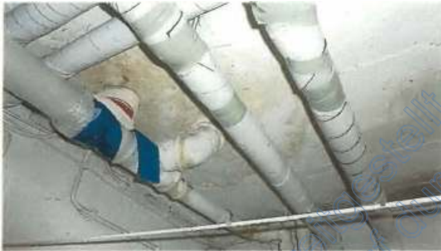
ehemaliger Deckenfeuchteschaden im KG und gr.tls. urspr. Installationen
