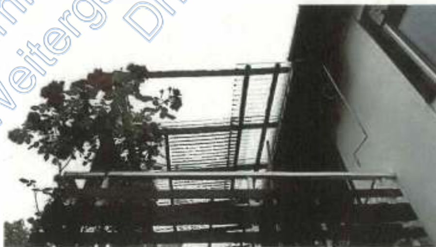
defekter Dachbereich Balkon
