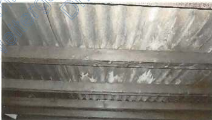
Feuchteprobleme im Dachbereich Carport
