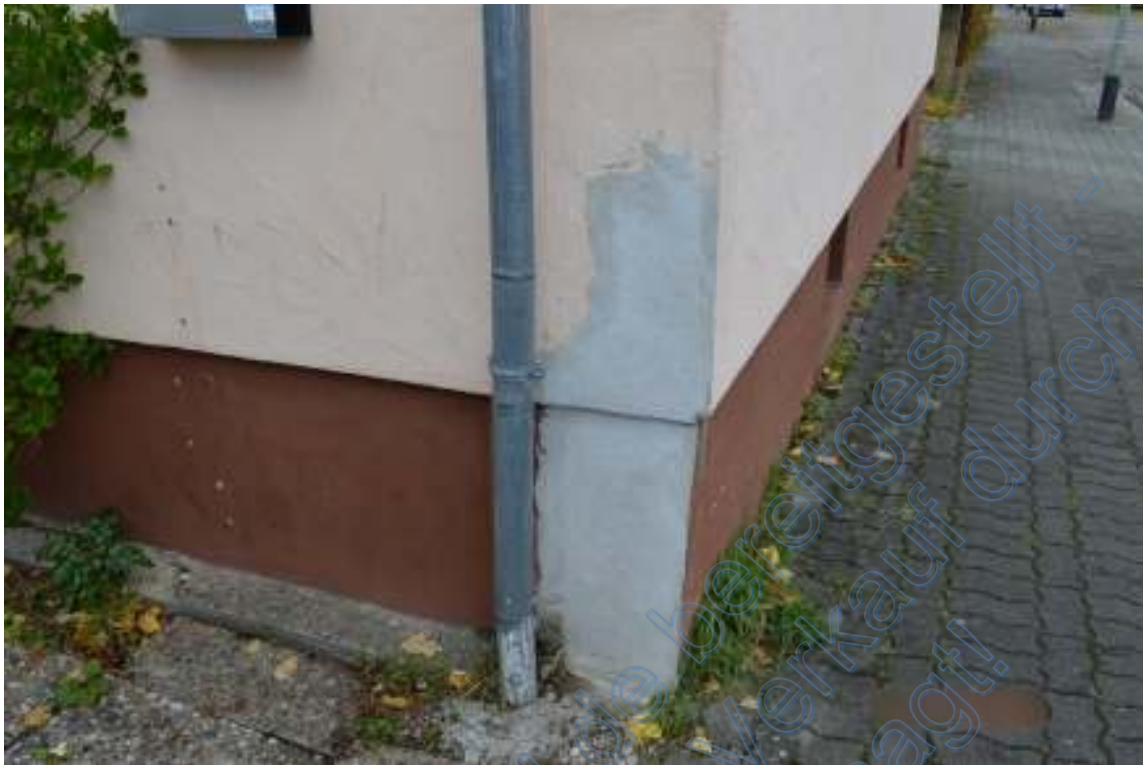
Foto Nr. 17 Nordostecke Putzschaden
