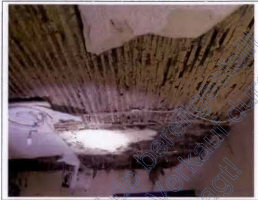
Foto 15 Wasserschaden Wohnhaus EG Decke
