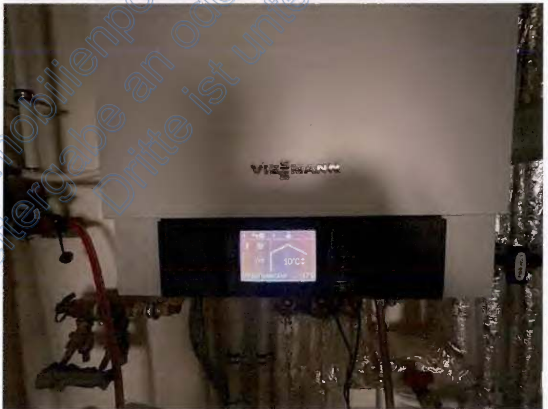
Innengerät Viessman Wärmepumpe
