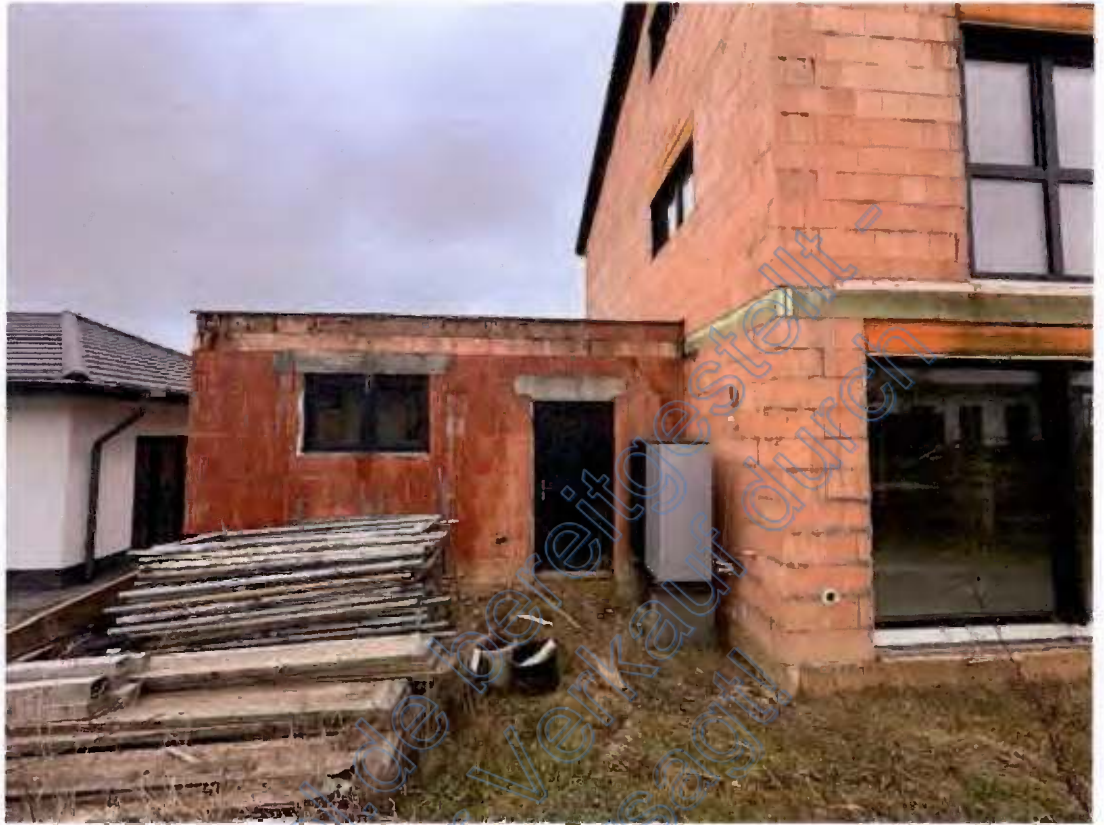
Rückseite Garage mit Wärmepumpe
