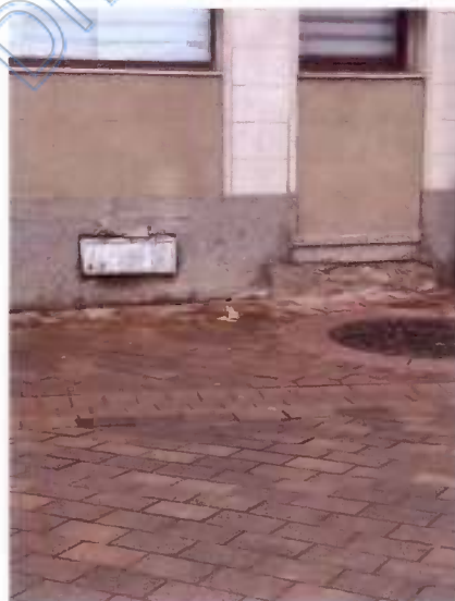
Abplatzungen im Sockelbereich
