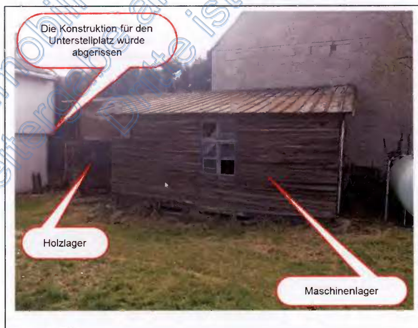
Foto 6 SE Nr. 1: Maschinenlager, Holzlager, Unterstellplatz Die Konstruktion für den Unterstellplatz wurde abgerissen
