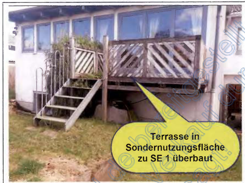
Foto 9 SE Nr. 2: Terrasse in Sondernutzungsfläche zu SE 1 überbaut
