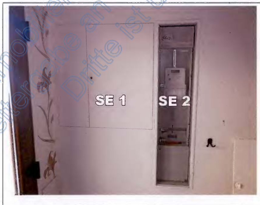
Foto 16 Stromverteiler zu SE 2 befindet sich in Räumlichkeiten von SE 1
