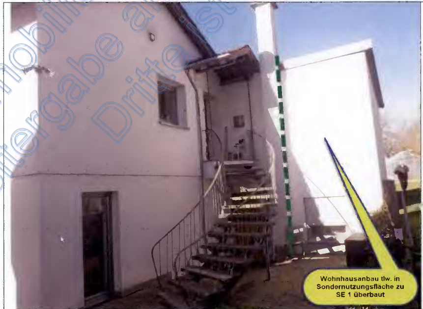
Foto 8 SE Nr. 2: Wohnhausanbau tlw. in Sondernutzungsfläche zu SE 1 überbaut
