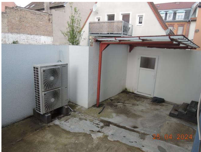
Bild 8: Hof des Bewertungsgrundstücks mit Wärmepumpe
