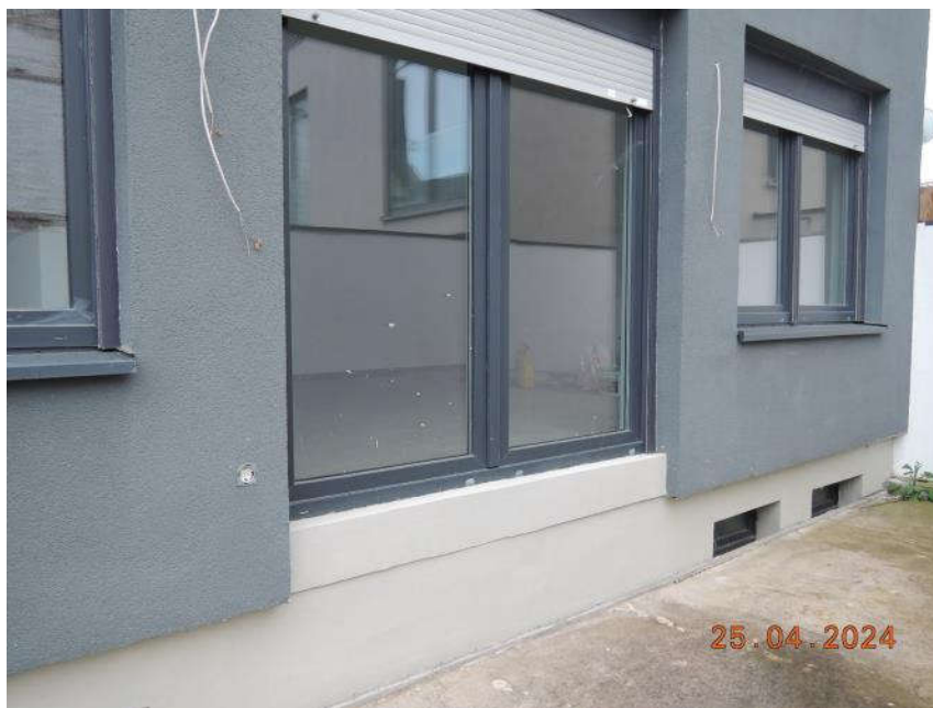
Bild 34: Fehlende Absturzsicherung im Erdgeschoss
