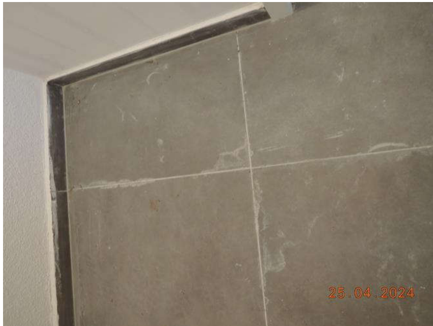
Bild 31: Bodenfliesen im Kellergeschoss mit Wasserflecken
