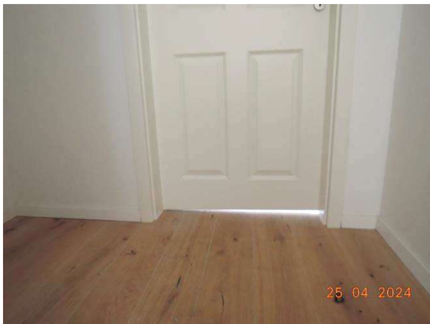
Bild 22: ungleiches Türspaltmaß im Obergeschoss
