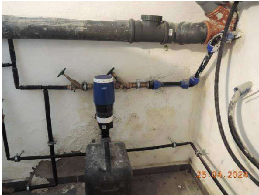
Bild 29: Feuchtigkeitsschäden im Technikraum
