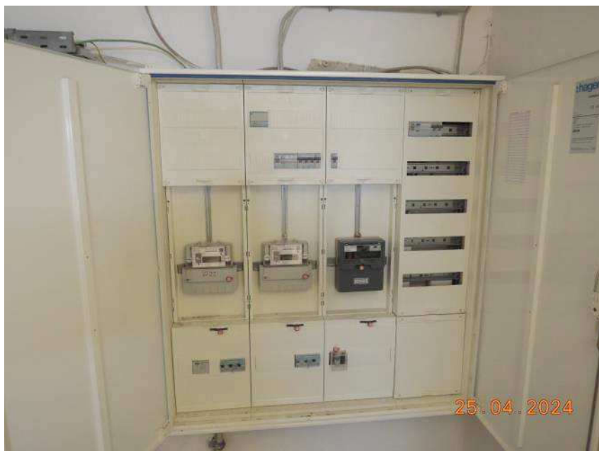
Bild 32: Elektrik/Zählerschrank im Technikraum (KG)
