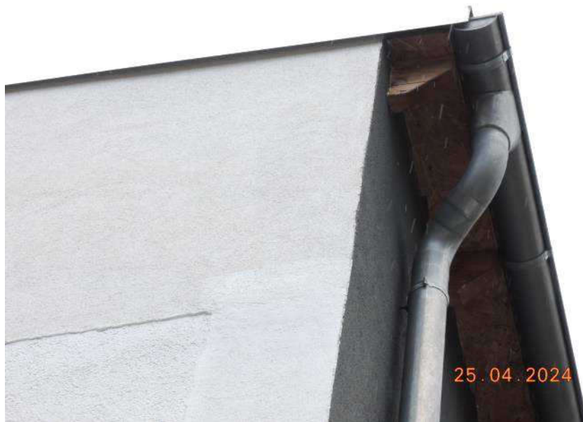
Bild 35: Giebelbereich ohne Fassadendämmung
