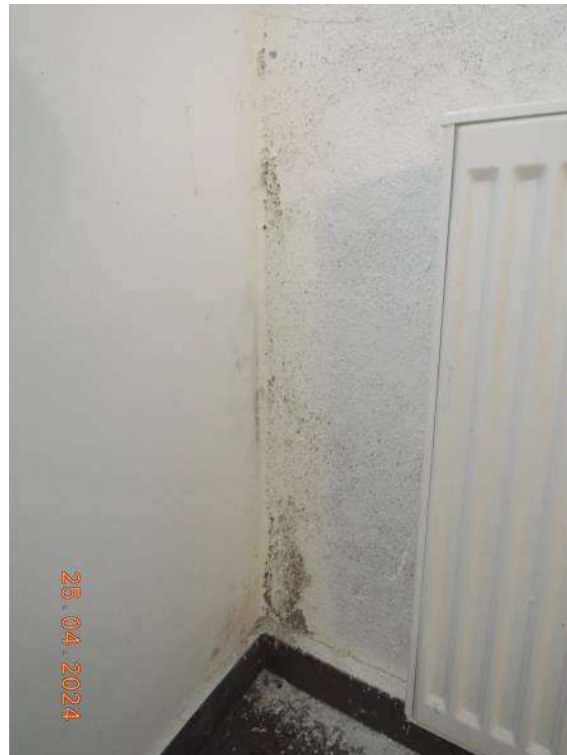
Bild 27: Feuchtigkeitsschäden mit Schimmelbildung an der Außenwand im Kellergeschoss
