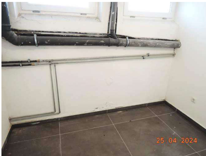
Bild 30: Kellerraum mit Feuchtigkeitsschäden an der Außenwand
