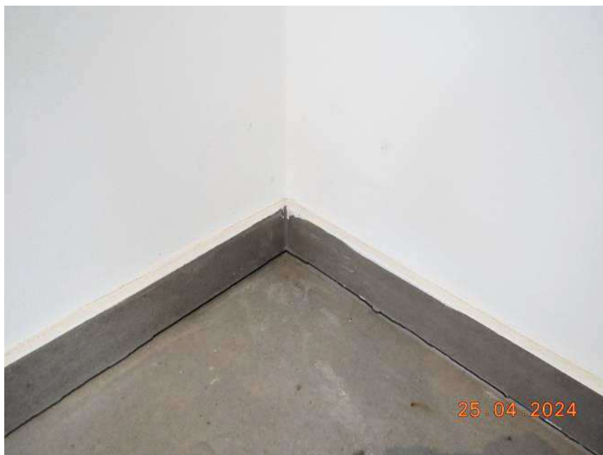
Bild 12: gerissene Dehnungsfugen im Erdgeschossbereich
