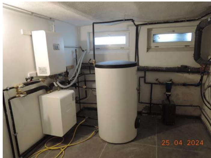
Bild 28: Technikraum im Kellergeschoss
