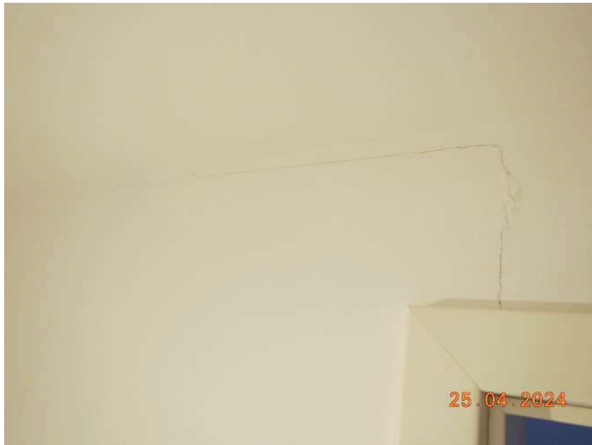
Bild 21: Putzrisse an der Wand im Obergeschoss
