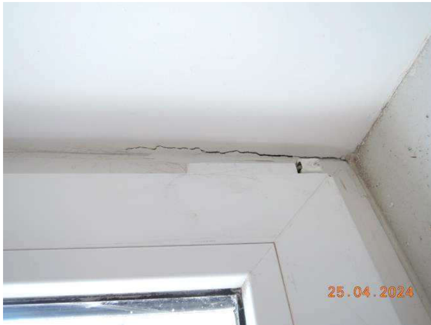
Bild 15: Putzriss am Fensterrahmen (EG)
