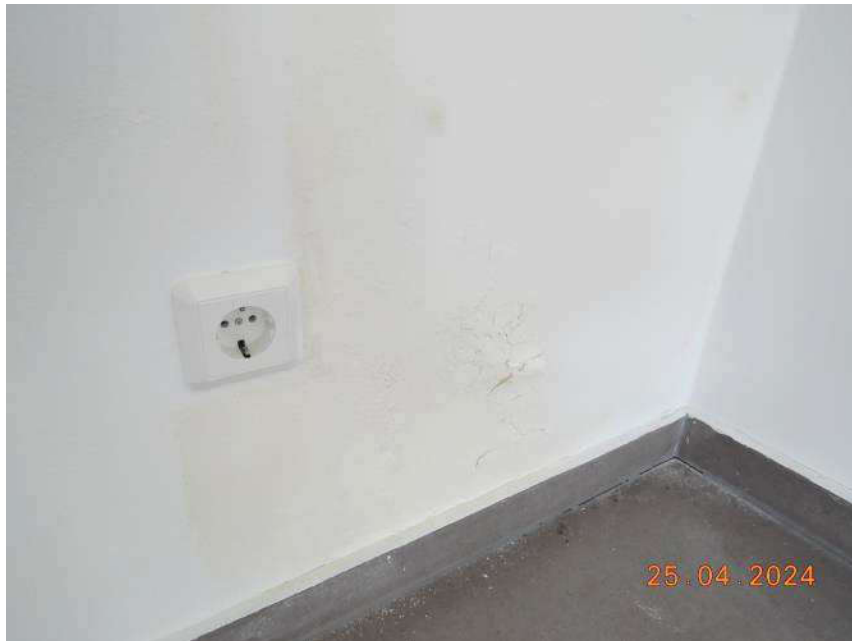
Bild 13: Putzschäden an der Wand im Erdgeschoss
