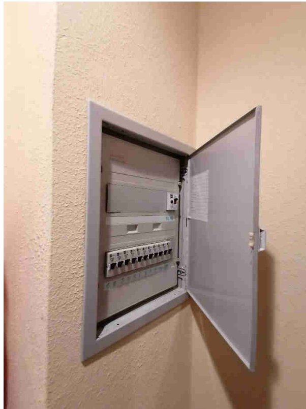
Aufnahme 13: Elektrounterverteilung ETW Nr. 8
