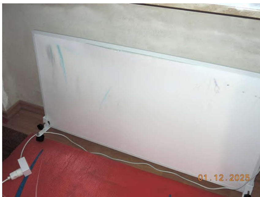
Abb. 14: Elektroheizkörper der Wohnung im 2. Obergeschoss links
