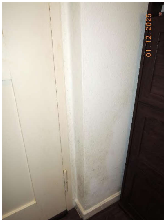
Abb. 9: Feuchtigkeitsschäden (Eingangsbereich) in der Wohnung im Erdgeschoss rechts
