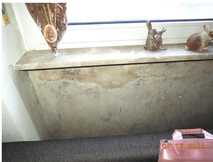
Abb. 8: Feuchtigkeitsschäden (straßenseitige Außenwand) in der Wohnung im Erdgeschoss
