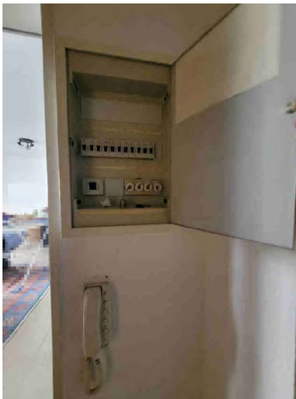
Aufnahme 11: Beispiel Wohnungsunterverteilung
