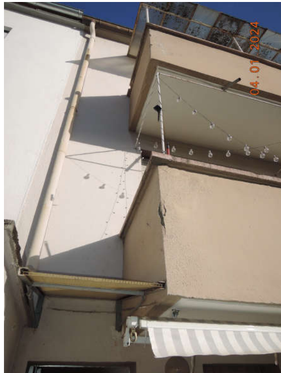
Abb. 16: Schäden an den Balkonbrüstungen außen
