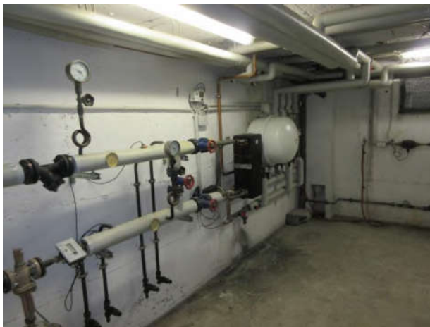
Haustechnik im Keller
