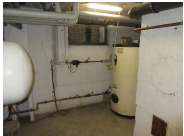
Haustechnik im Keller
