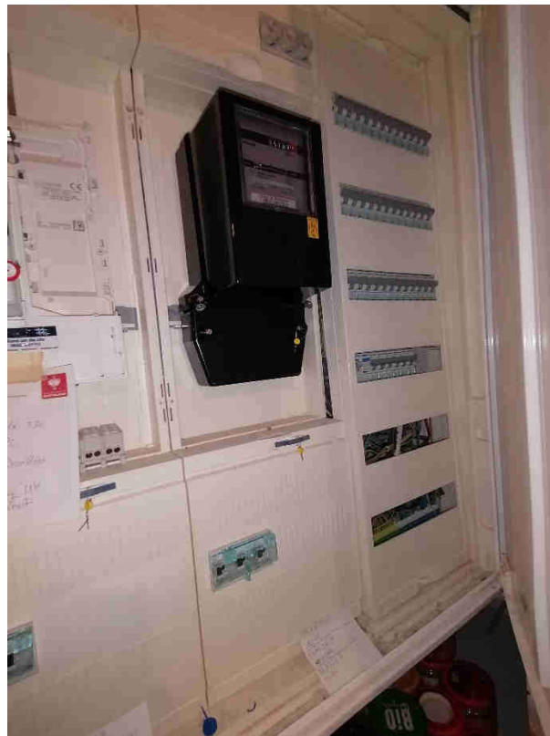
Aufnahme 11: Zählerschrank mit Sicherungen
