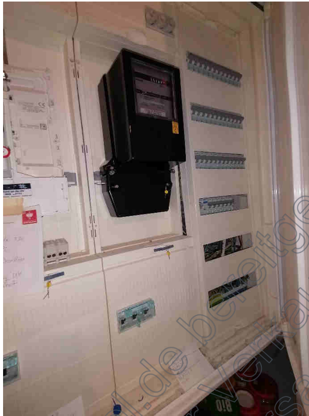
Aufnahme 11: Zählerschrank mit Sicherungen
