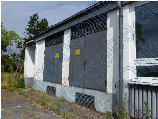
Trafostationen im Gebäude
