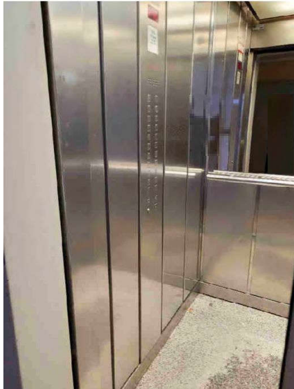
Aufnahme 13: Innenansicht Aufzug
