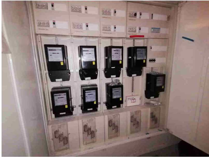
Aufnahme 11: Zentraler Zählerschrank im Kellergeschoss
