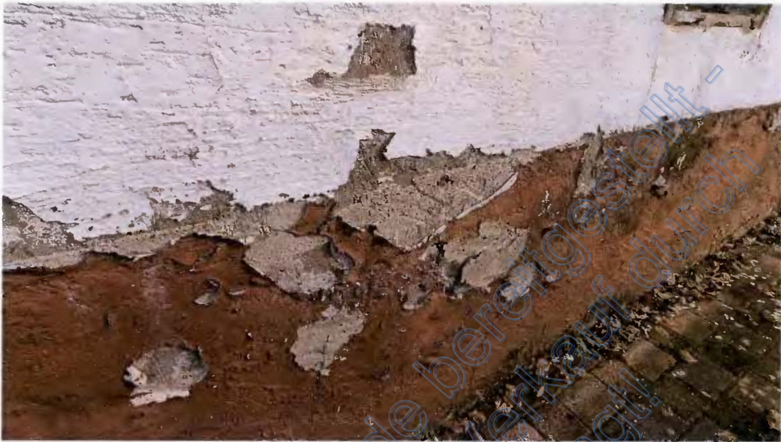
Bild 7: Schäden am Außenputz
