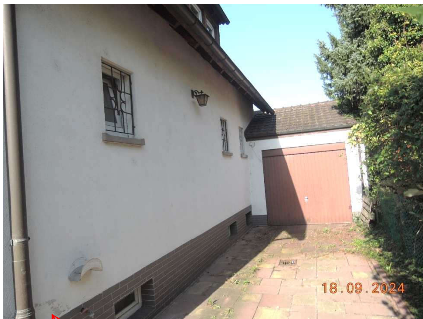
Bild 4: Seitenansicht des Wohnhauses und Garage, Feuchtigkeitsschäden
