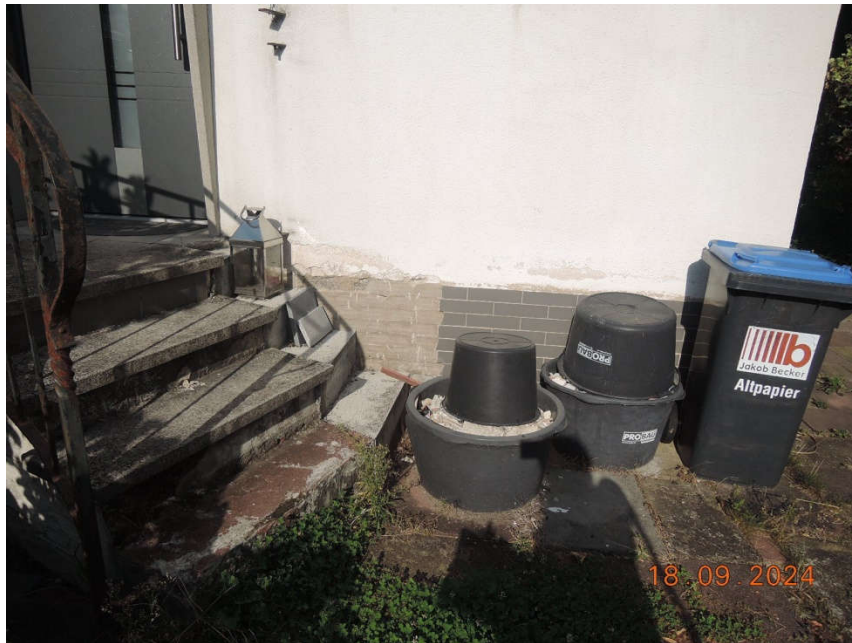
Bild 3: Hauseingangstreppe und Feuchtigkeitsschäden im Sockelbereich der südöstlichen Ecke des Wohnhauses
