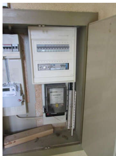
Elektro-Unterverteilung der Wohnung Nr. 8
