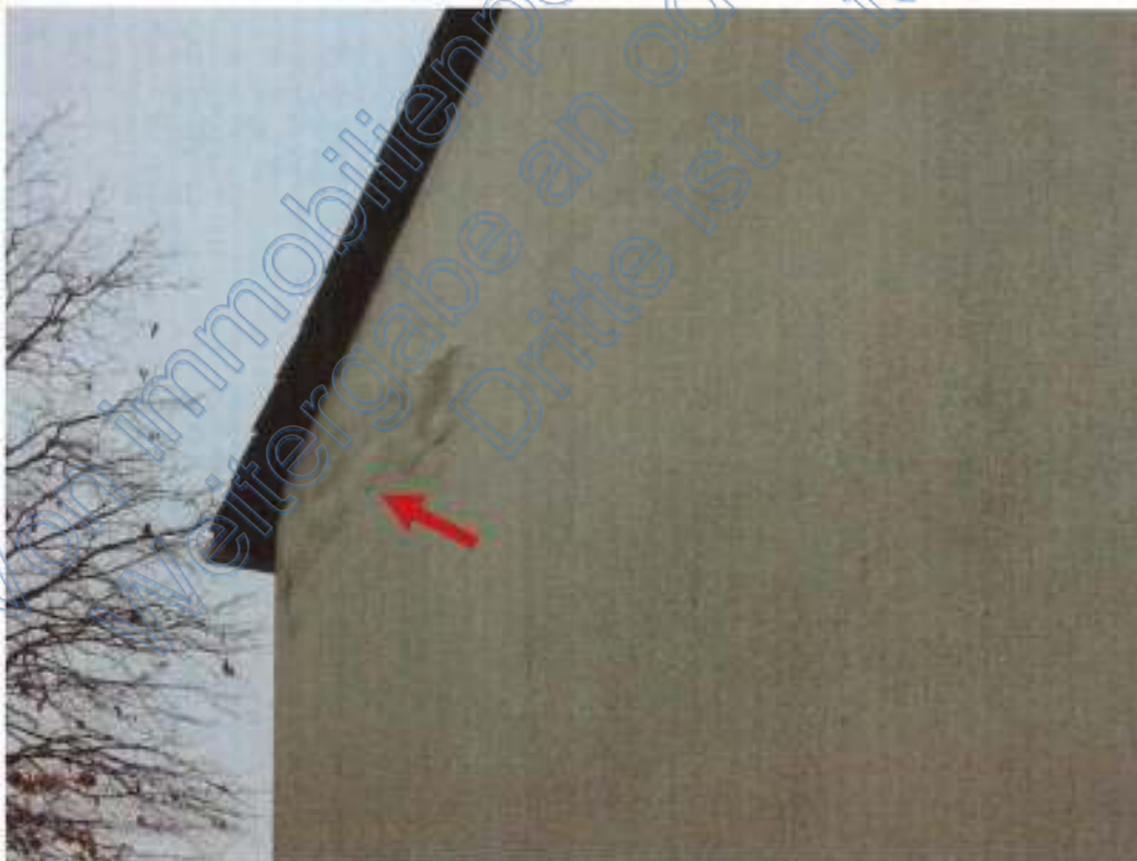
Feuchtigkeit und Risse an der Fassade an mehreren Stellen der Fassade
