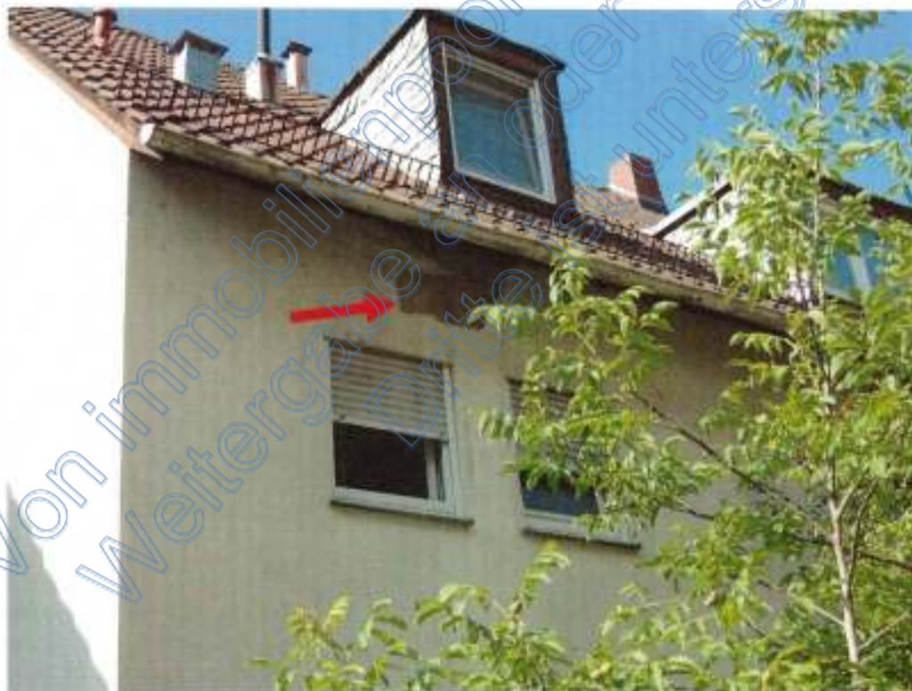
Feuchtigkeit und Risse an der Fassade
