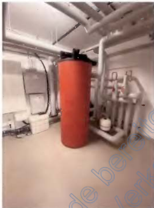
Bild 9: Blick in den Heizungsraum (Am Judensand 27)
