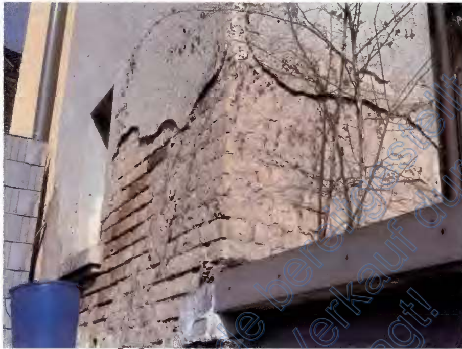
Bild 11: Blick auf schadhaften Außenputz
