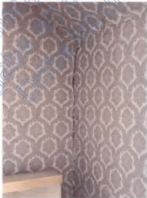
Bild 14: Blick auf einen Riss im Schlafzimmer im Dachgeschoss
