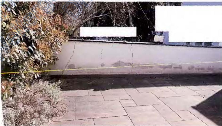
Putzschäden seitliche Einfriedungsmauer
