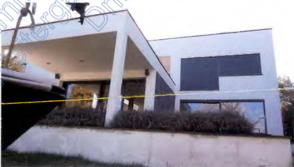
Teilrückansicht Wohngebäude / Stützmauer der Terrasse mit partiellen Putzschäden
