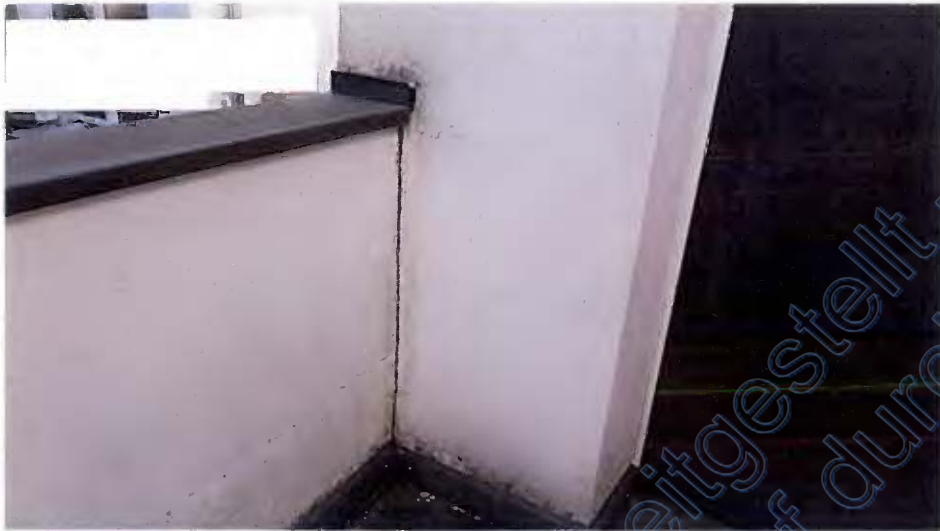
rückseitiger Sockel der Garage mit Feuchteschäden / Rissbildung Einfriedungsmauer zur Garage
