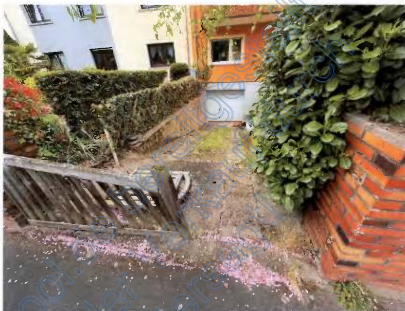
Abb. 3: Foto des SV; z.T. Einfriedungen (Holzzaun) schadhaft
